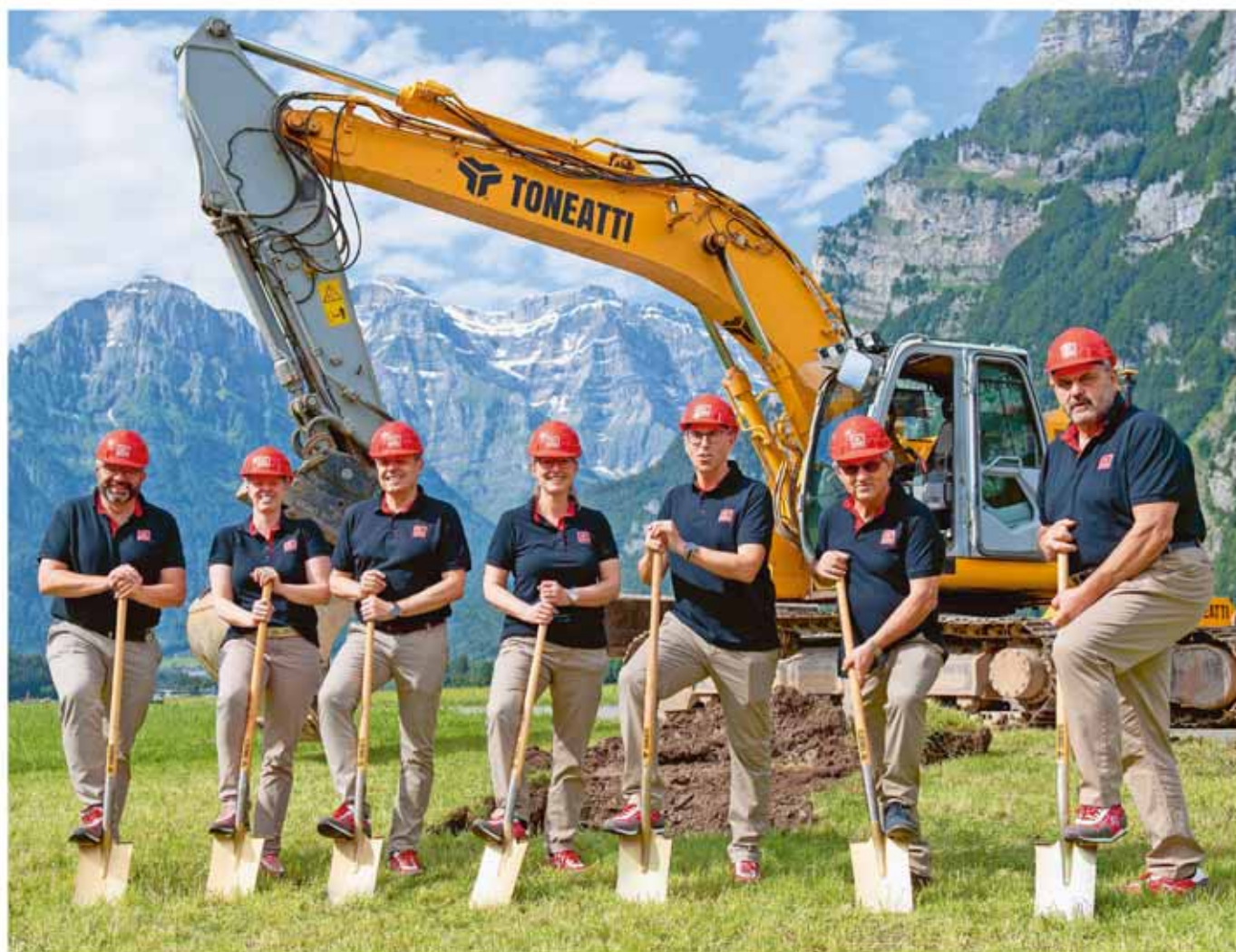
Spatenstich, v.l.: OK-Präsident Jakob Kamm, Katrin Egger, Bereichsleiterin Kommunikation und Marketing, Walter Hofmann, Geschäftsleiter, Tina Wintle, Ressortleiterin Medien, Urs Bachmann, Bereichsleiter Infrastruktur, Jacques Steinmann, Ressortleiter Bau, und Hans-Ruedi Hauser, Präsident Trägerverein, haben mit dem Spatenstich die Bauarbeiten feierlich eröffnet. Bild: Taria Hösli, ESAF 2025 Glarnerland+
