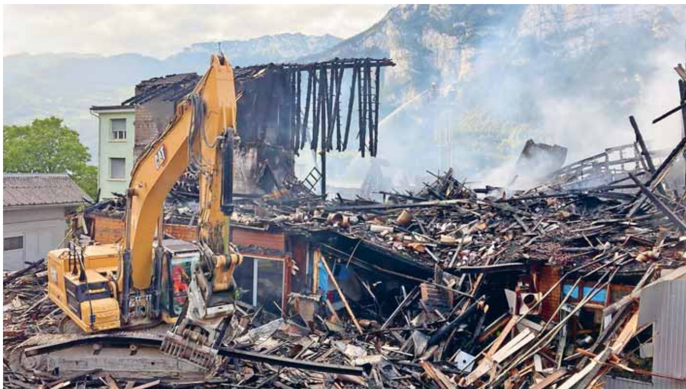
Abbildung 21: Einsatz der Feuerwehr beim Grossbrand in Mühlehorn (Kanton Glarus)
